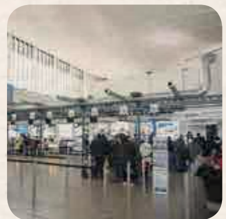
Lüftungsanlagen im Bereich des Check-ins
